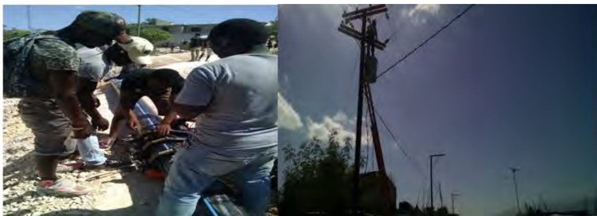
Image 1: Des techniciens et un tuyau de circulation de l'eau
