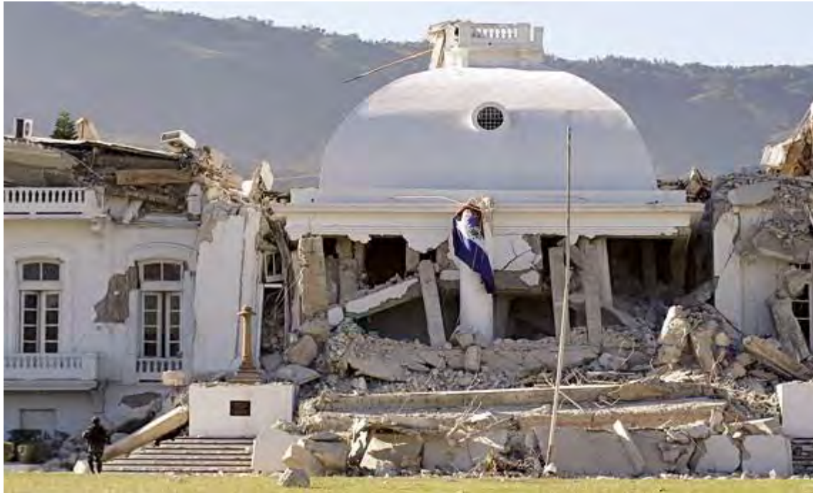
Figure1 : Palais national effondré
