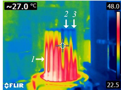
Figure VI-36 : Image thermique infrarouge du condenseur n°2-4 ( \dot{Q}_{tot}/\dot{Q}_{cp} = 95/54 W)
