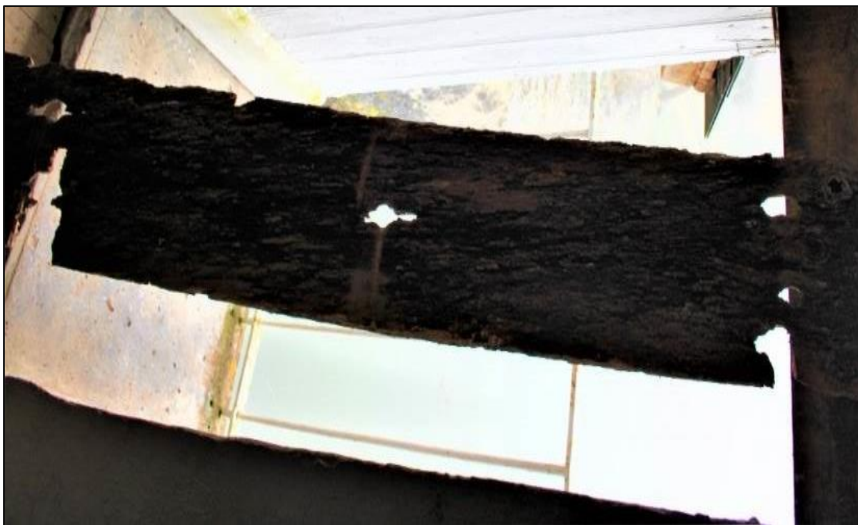
Figure 92 : L'état d'une ancienne planche de la roue du moulin de Thévalles (Photo réalisée par Francesco Donati).
