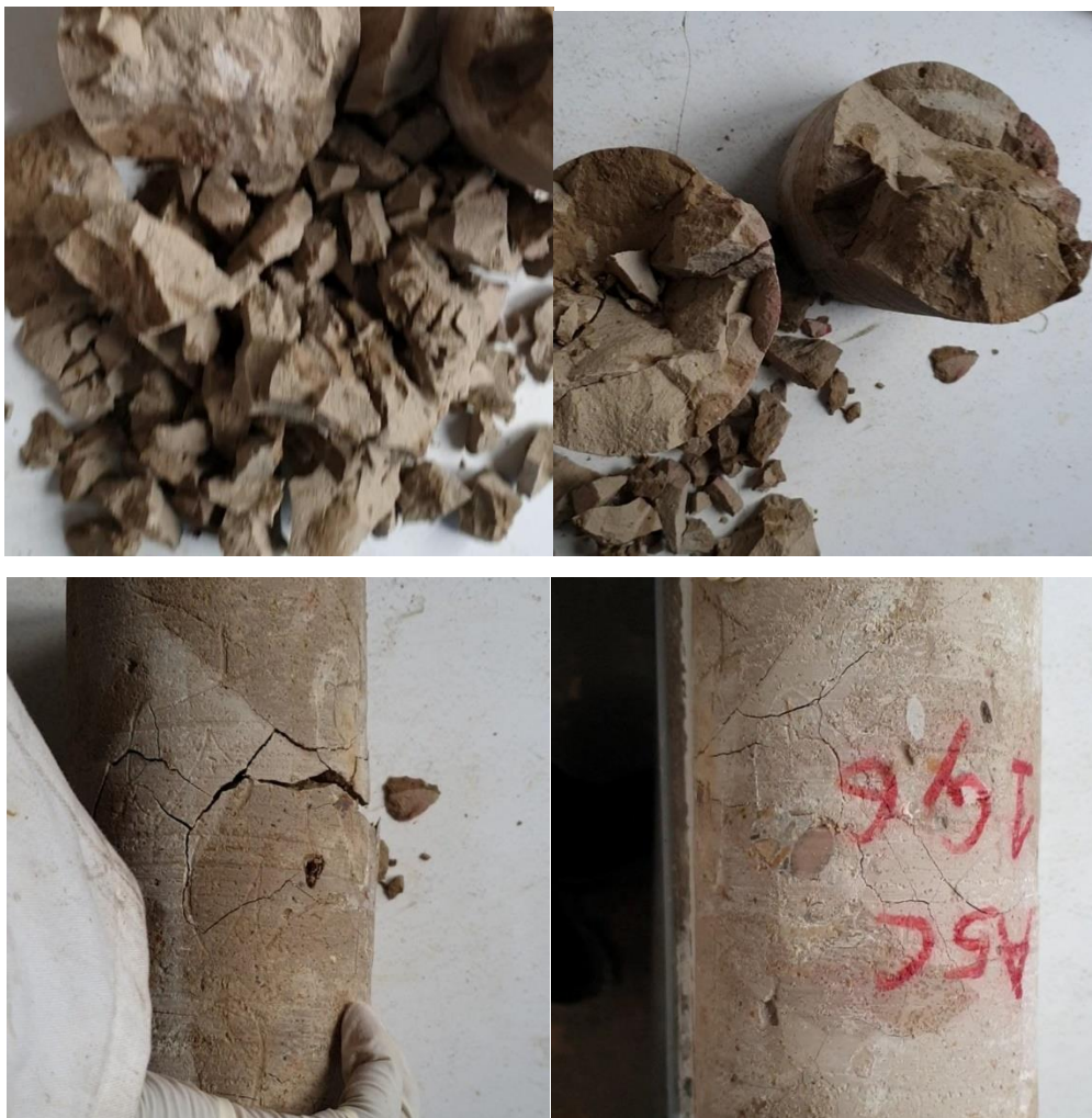
Figure VI-12 : Echantillons issus du chantier CS_1 après 6 cycles de gel/dégel : observations de fissures, émiettement de l'échantillons sous très faible sollicitation
