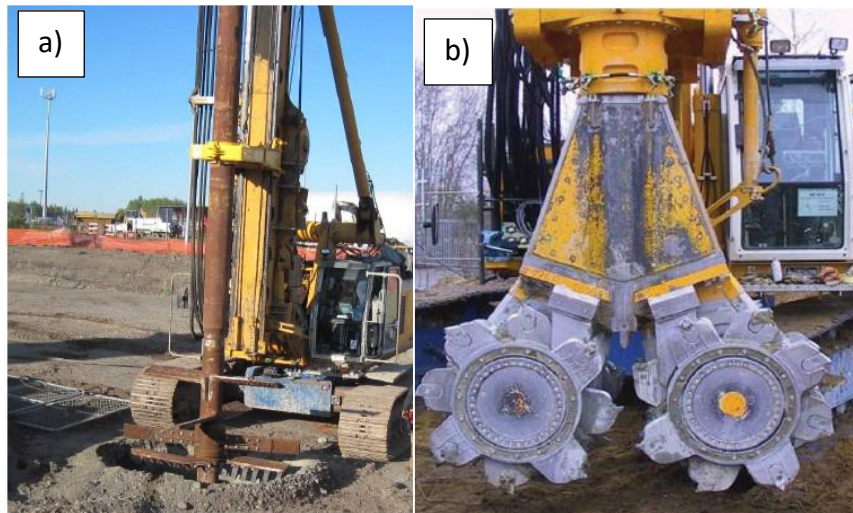
Figure I-3 : Soil Mixing par voie humide avec malaxage localisé a) ( Yamasaki et al. 2015 ) et le Cut Soil Mixing (CSM) b).
