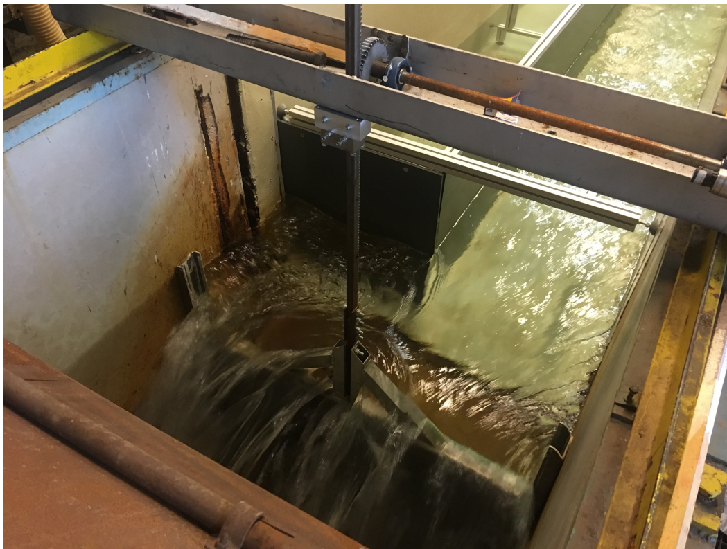
FIGURE 4.30 – Vanne utilisée pour contrôler le niveau de l'eau.
