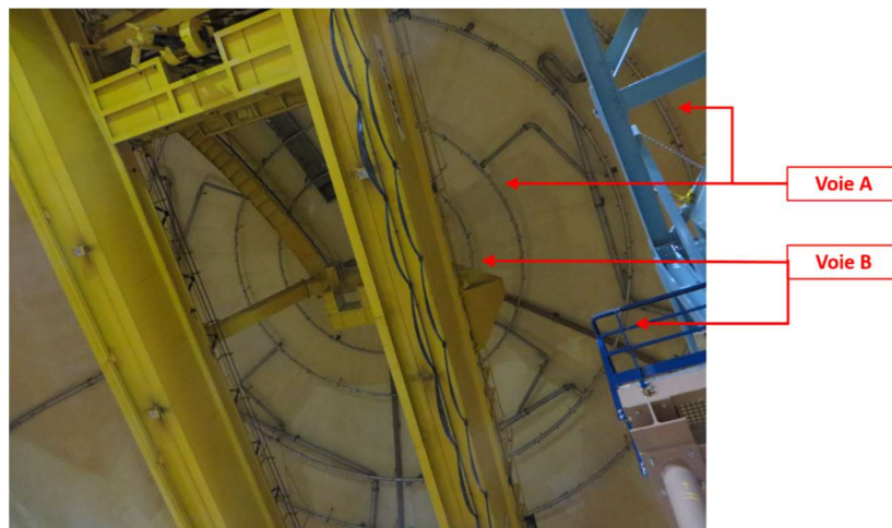
Figure 133. Photo des 4 couronnes d'aspersion des voies A et B
