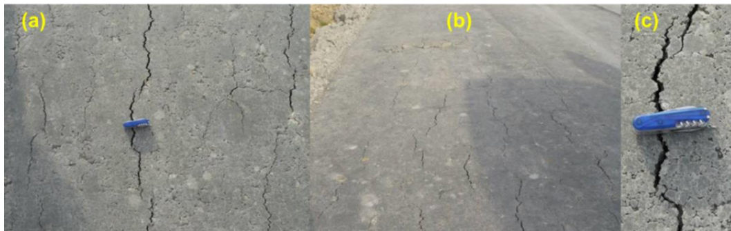
Figure VII.36 : Fissuration de dessiccation sur la planche 1BmV5 (Pelizzari 2014).
