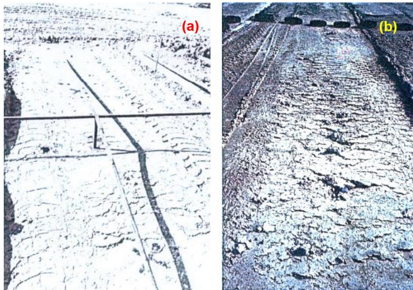
Figure P1-II.10 : Feuilletage (a) d'un limon traité à la chaux et (b) d'une grave traitée au ciment (Dandjinou 1988).
