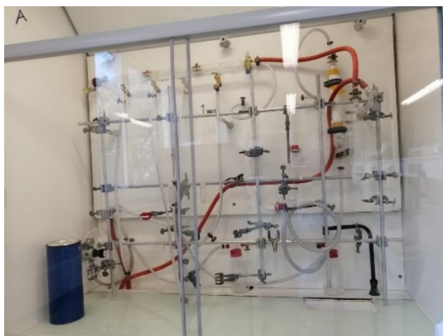
Figure 2- 6: Rampe mixte vide-argon installée sur une sorbonne équipée d'une hotte aspirante
