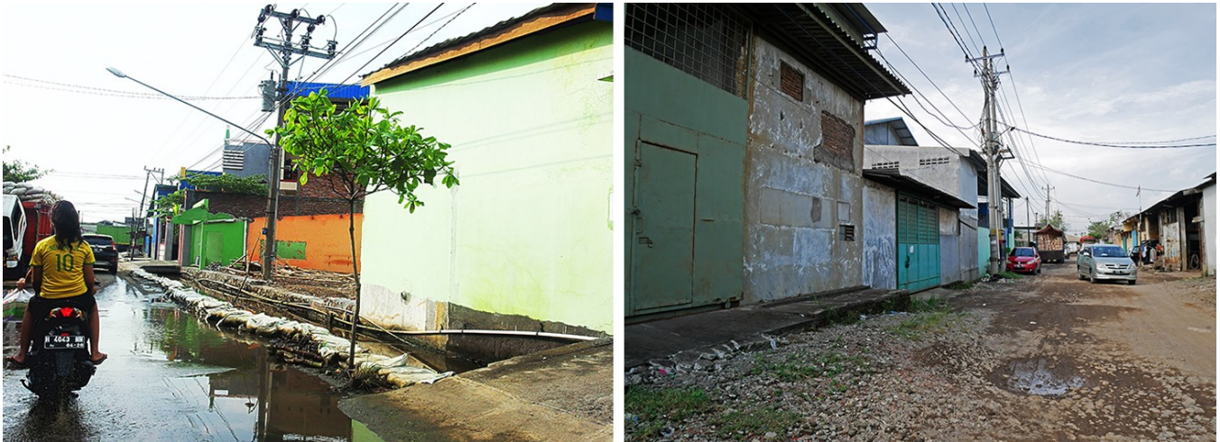
Photo 20 : Une zone industrielle de première génération : lutte contre le rob* (à gauche) et rue défoncée (à droite) à LIK
