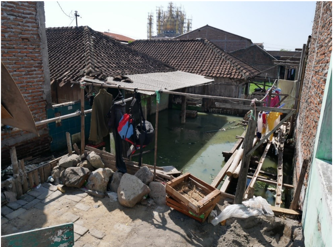
Photo 40 : Rob*, maisons affaissées (aux 2 ème et 3 ème plans) et surélévation en cours de la terrasse de la maison 01A
