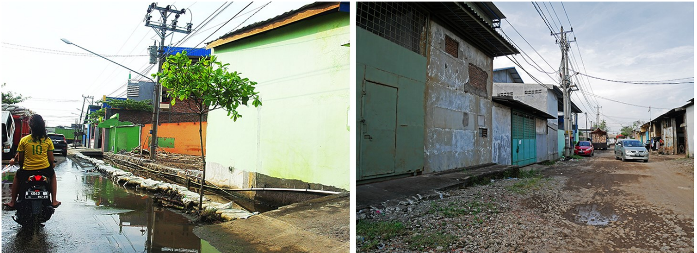
Photo 20 : Une zone industrielle de première génération : lutte contre le rob* (à gauche) et rue défoncée (à droite) à LIK
