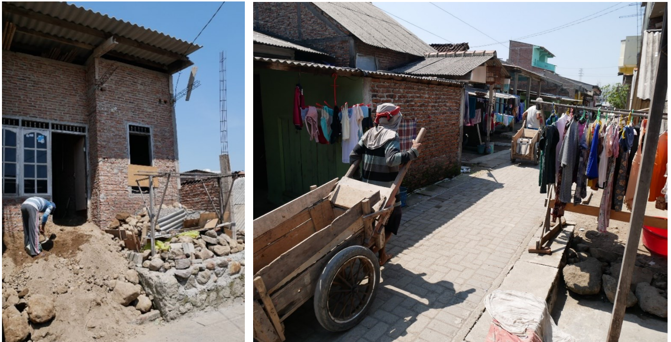
Photo 44 : Acheminement à pied des matériaux nécessaires à la surélévation d'une maison Jl. 14
