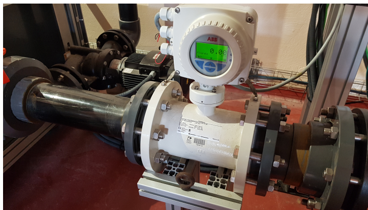
FIGURE 3.16 – Photo du débitmètre installé sur la ligne de retour au réservoir inférieur.
