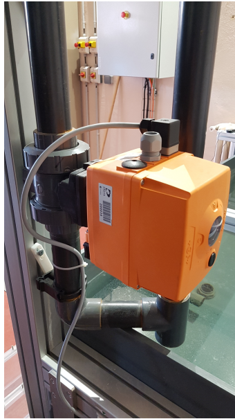
FIGURE 3.26 – Photo de la vanne pilotée installée sur la ligne de fuite entre les réservoirs supérieur et inférieur.
