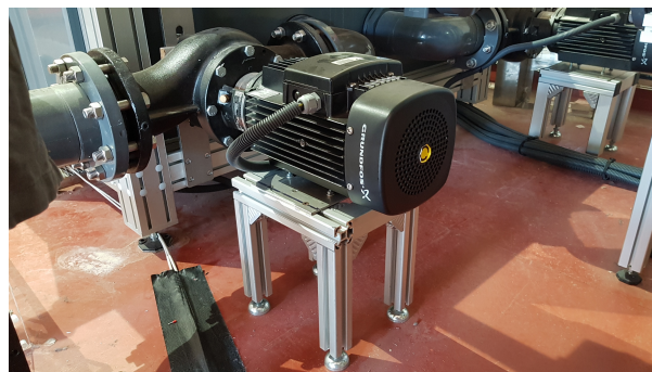
FIGURE 3.22 – Une pompe et son support. Le support permet de bloquer le mouvement de balourd de la pompe.
