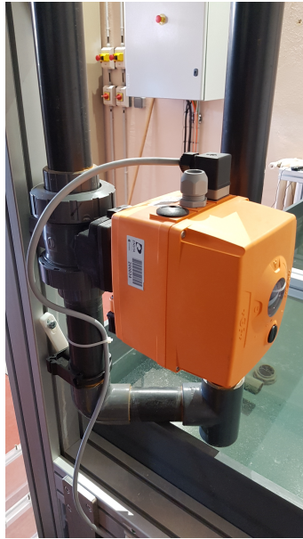
FIGURE 3.26 – Photo de la vanne pilotée installée sur la ligne de fuite entre les réservoirs supérieur et inférieur.
