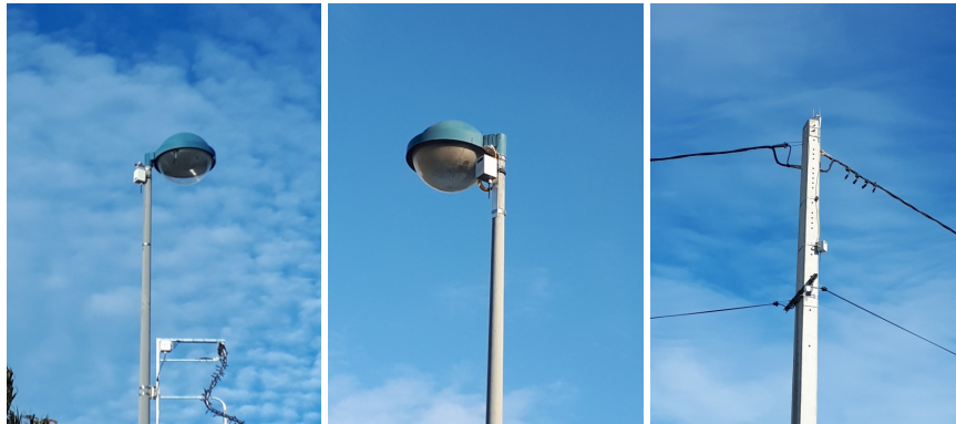
FIGURE 4.2 – Pyranomètres aux points C, D et K, installés à Villeneuve-de-la-Raho sur des lampadaires et un poteau électrique.
