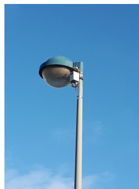
(b) Le pyranomètre au point D, installé sur un lampadaire.
