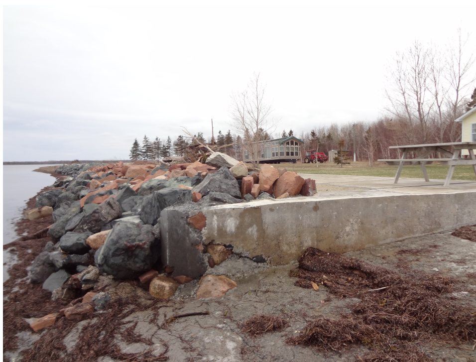
Photo 1 : Exemple d'encochement d'une propriété de bord de mer, Nouveau-Brunswick. M. Noblet, 2012.
