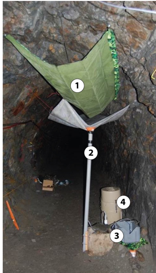
Figure 36: Dispositif en place aux exutoires G1 et G2 : 1. Bâche de récupération des eaux de ruissellement, 2. Collecte des eaux, 3. Bac de récupération des eaux (permet l'installation de sondes de mesures et prélèvements), 4. Instrumentation (préleveur automatique, sonde CTD, station mesure de débit).
