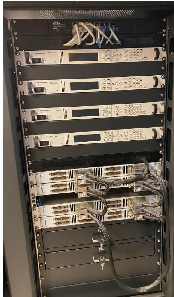
Figure IV. 36: Banc de pilotage et d'alimentation DC multivoies.
