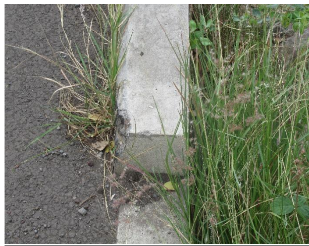
Photo 50. Traces d'un accident lié à la présence d'une noue paysagère à Cœur de Ville. Crédit : Collectivité, agent.
