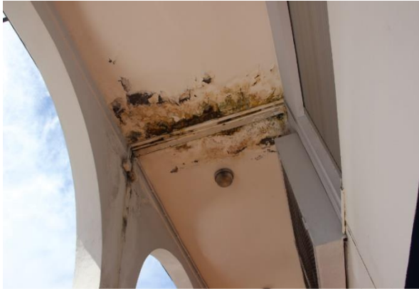
Photo 55. Moisissure au plafond d'un immeuble (Saint-André). Crédit : Centre-ville Saint-André, homme, 30 ans.
