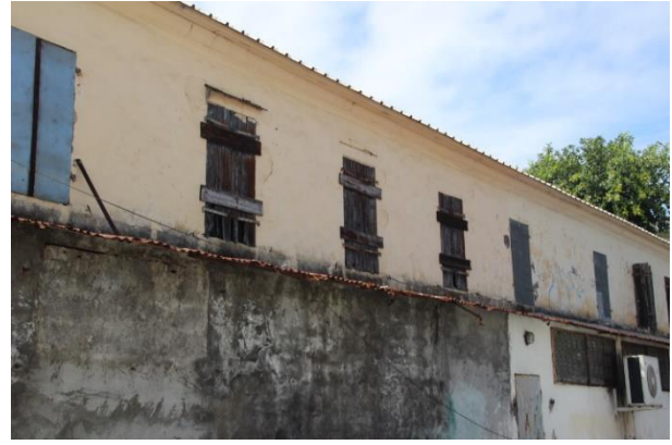
Photo 56. Bâtiment dégradé (Saint-André). Crédit : Centre-ville Saint-André, homme, 30 ans..
