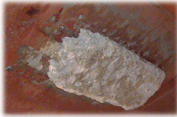
Figure 1 - 12 : Photo prise d'une anode sacrificielle lors de la visite d'un navire en cale sèche pour une opération de maintenance (Juin 2019)
