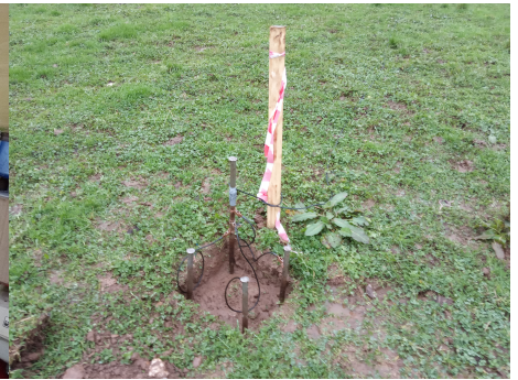
(d) Picture of one of the TX pole
