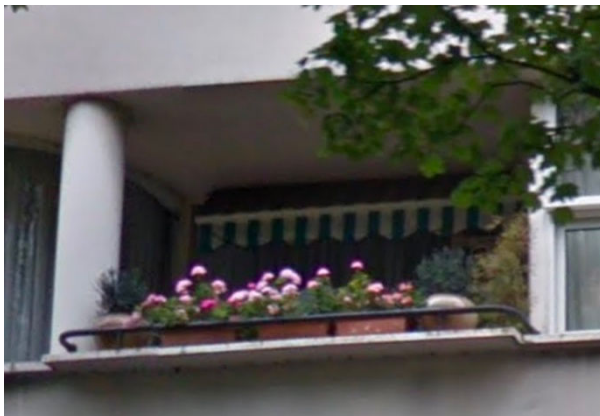
Figure 137 : Jean Ginsberg, 25 av de Versailles 16 e , 1931, Innovation affirmée, garde-corps élémentaires, cliché GM.
