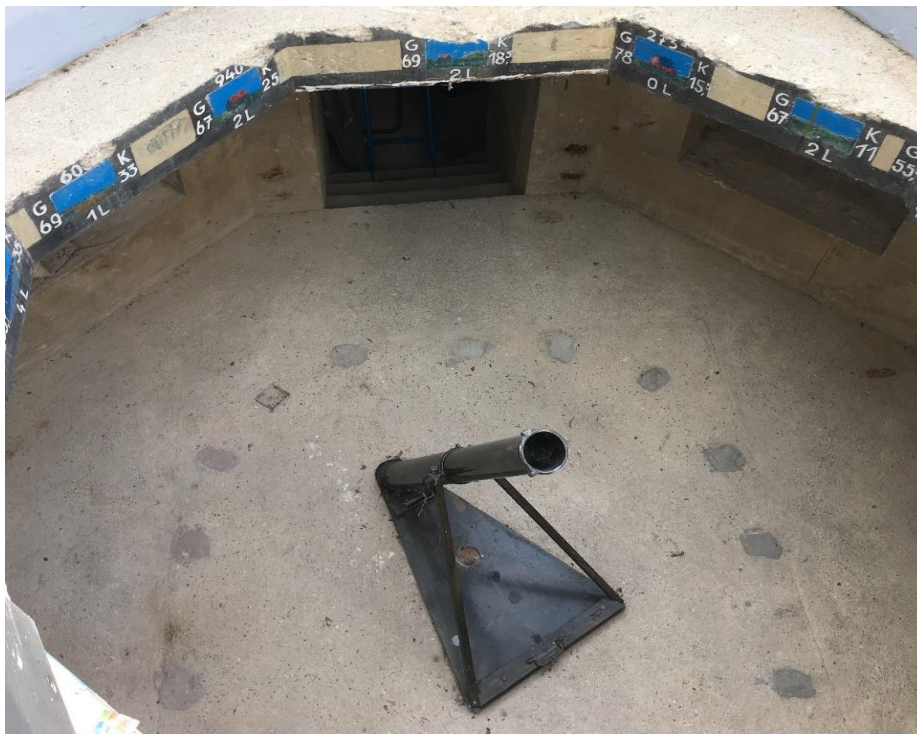
Exemple de mise en place du mortier et des repères pour le tir au sein d'un R69. Musée Utah Beach. ©Graffard T.
