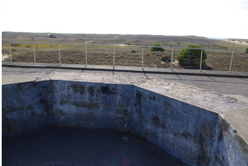
Détails du premier encuvement à la Faute-sur-Mer (Sa88). On observe que les soutes à munitions ont été obstruées par la restauration de l'ouvrage. ©Graffard T.
