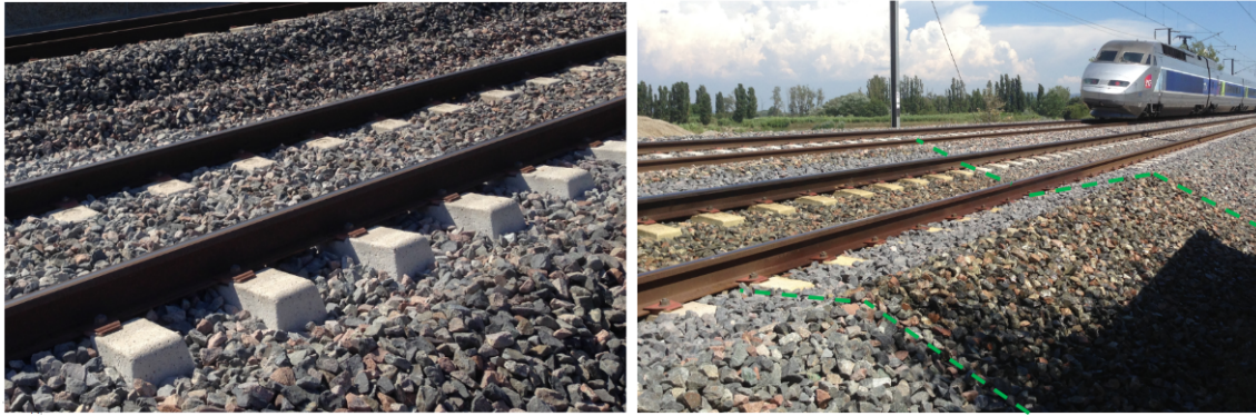
FIGURE 1.12 – À gauche, exemple de fluage de ballast qui a dégarni les traverses en 2015 (photo prise avant la correction géométrique et le collage) ; à droite, la même section en 2017.
