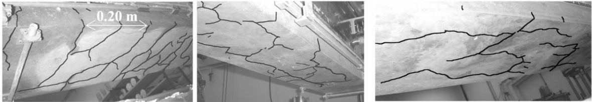
Figure II-42 Fissurations obtenues pour les poutres réactives non armée (B1) armée (B3) et fortement armée (B4) [Multon et al., 2005]
