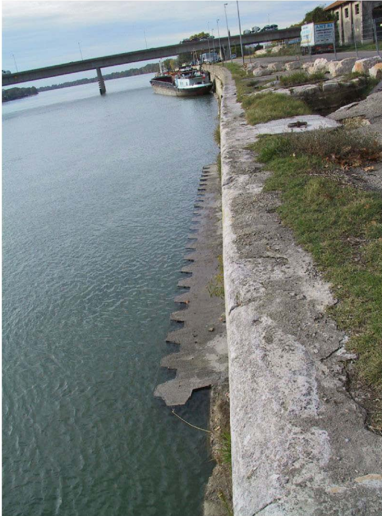
Figure 73. Dégradation et protection des quais d'Arles Protection du quai de la Gabelle (Arles) à l'aide de palplanches
