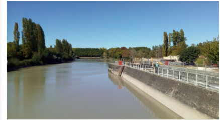
Photo 1 - Chantier en cours d'une passe à poisson sur le fleuve Charente à Saint-Savinien (17) pour assurer la libre circulation des poissons migrateurs au niveau du barrage (04/10/2018).
