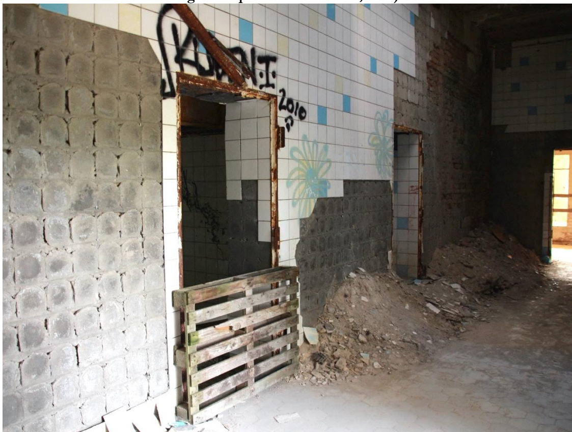
Photographie 5.6. Les entrées condamnées de pièces accessibles en 2017 (visite de la Chirurgie organisée par Baum und Zeit, 2018)
