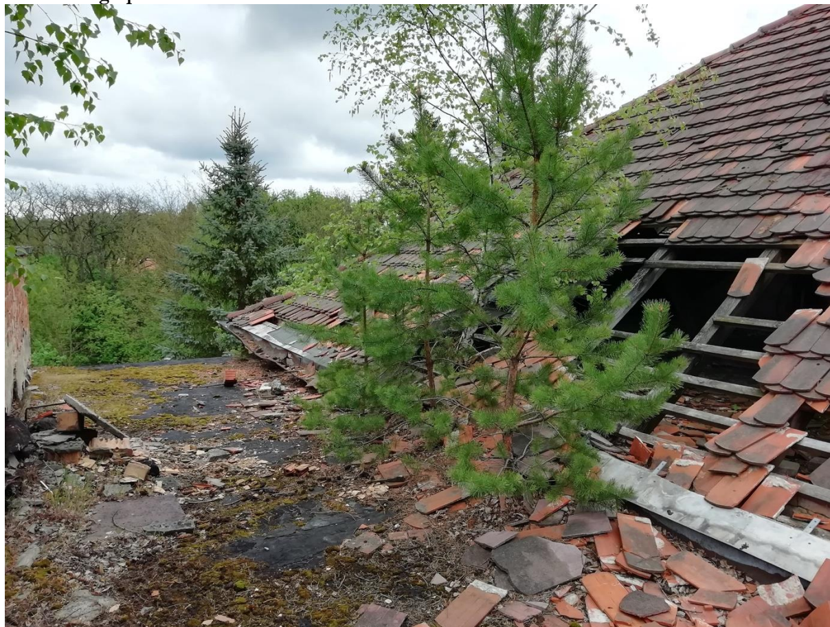
Photographie 4.42. Des zones non sécurisées facilement accessibles au cours des visites
