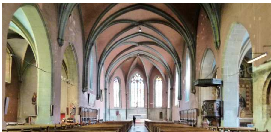
Doc. 61 - Annecy (dominicain) - Déformation du mur sud du choeur sous le poids du voûtement
