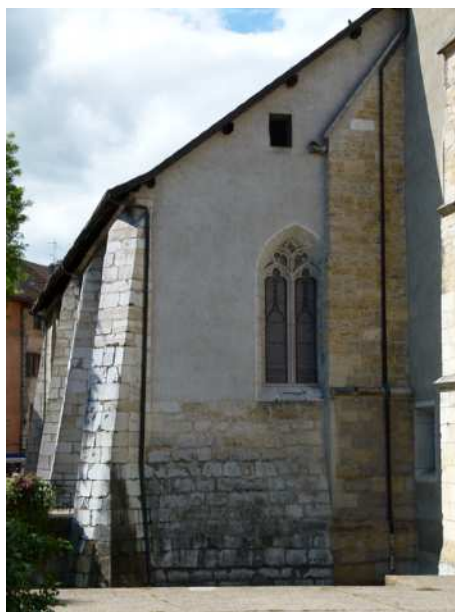
Doc. 58 - Annecy (dominicain) - Bas-côté sud. Mur de la chapelle édifié dans le prolongement du contrefort de la nef.
