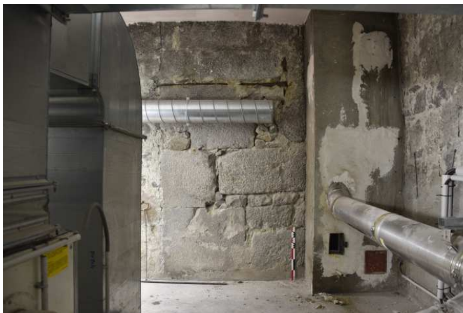
Fig. 147 - Chauffèrie (rez-de-chaussée du clocher), épaulement occidental de la nef (vue vers le nord)
