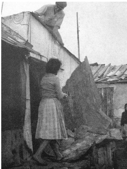
Un homme et une femme travaillant à la construction ou à la réparation d'un abri de fortune 291 .
