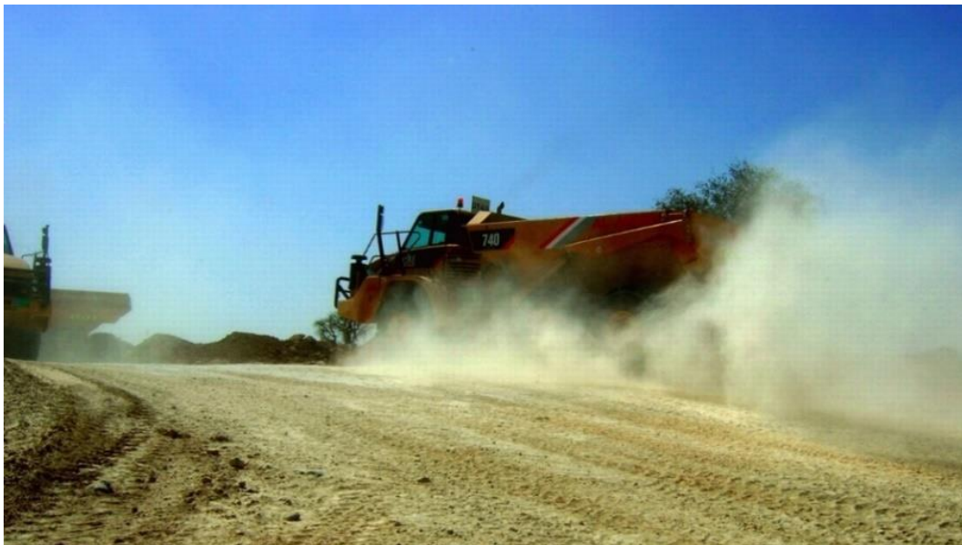
Figure 0-2 : Poussière générée par la circulation d'un tombereau articulé sur un chantier de terrassement (Walker, 2012)
