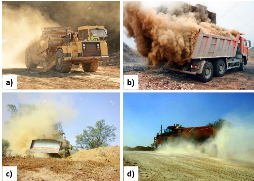
Figure 1-2 : Émissions de poussières lors a) du décapage du sol, b) du chargement des camions, c) des activités de bulldozer et d) de la circulation des engins (crédits : Getty Images et Walker, 2012)
