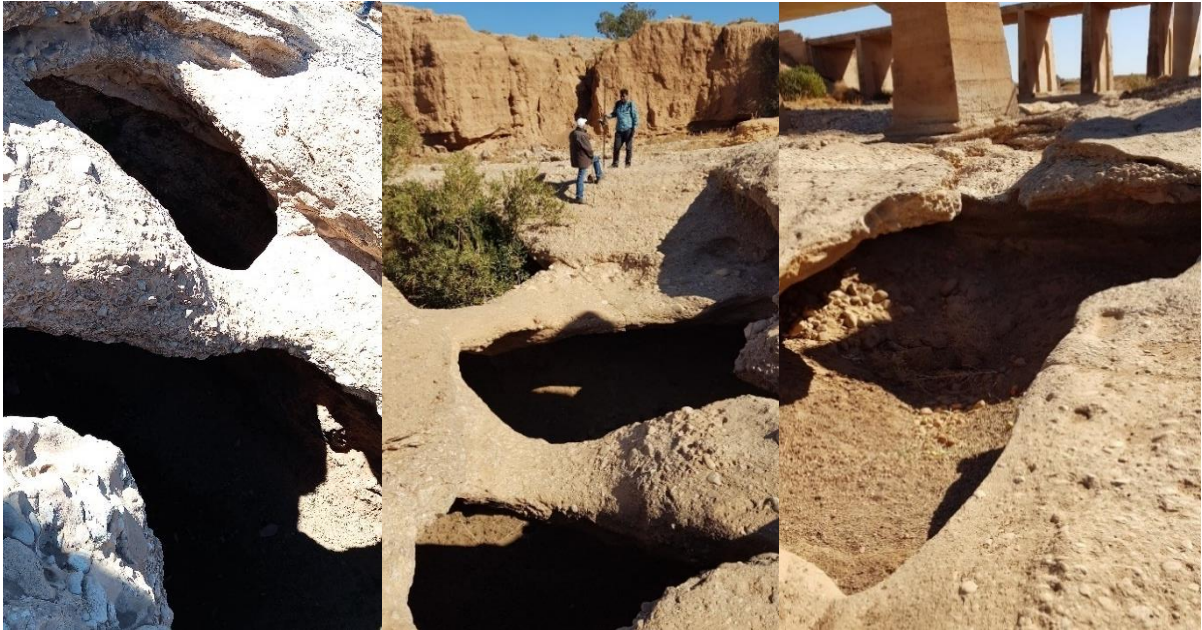
الصورة رقم 56: رصيص به عدسات الحث، مما يؤدي إلى حفر وعائية نتيجة الحفر في الأماكن الهشة، قنطرة الطريق الوطنية رقم 6، على وادي اتلاغ
