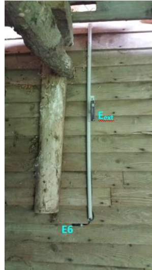
Figure IV-10 : Implantation des capteurs en surface et en ambiance extérieures en paroi nord
