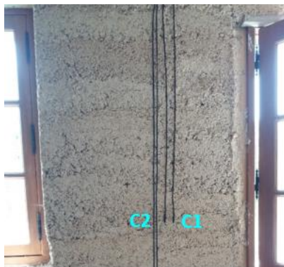
Figure IV-5 : Implantation des capteurs à l'interface béton de chanvre-enduit intérieur et en surface intérieure (en attente) en paroi sud
