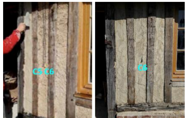
Figure IV-6 : Implantation des capteurs à l'interface béton de chanvre - enduit extérieur et en surface extérieure (en attente) en paroi sud
