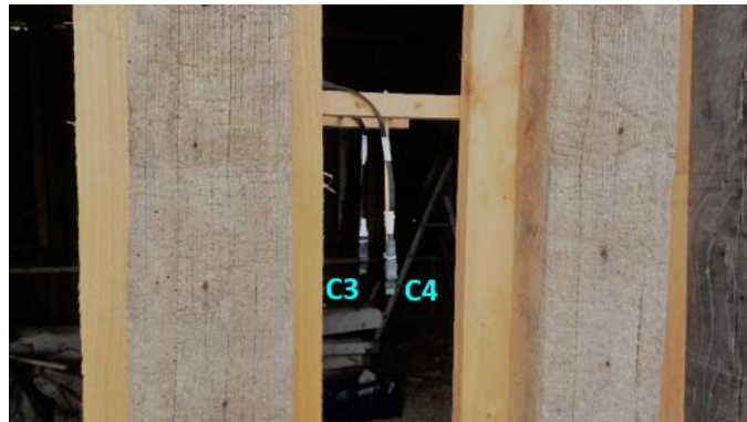
Figure IV-4 : Implantation des capteurs au sein du béton de chanvre en paroi sud
