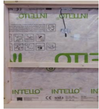
Figure II-25 : capteurs placés de chaque côté de la membrane
