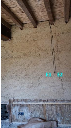
Figure IV-9 : Implantation des capteurs l'interface béton de chanvre-enduit intérieur et en surface intérieure (en attente) en paroi nord
