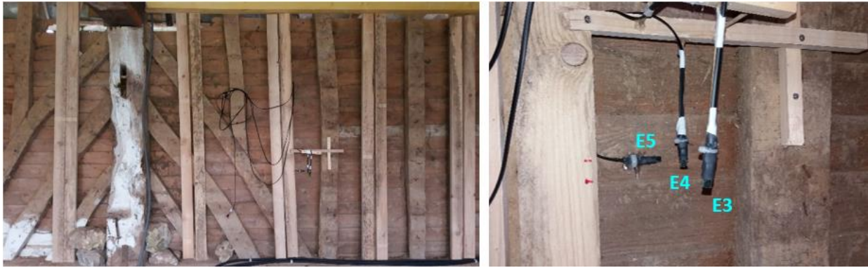
Figure IV-8 : Implantation des capteurs au sein du béton de chanvre en paroi nord
