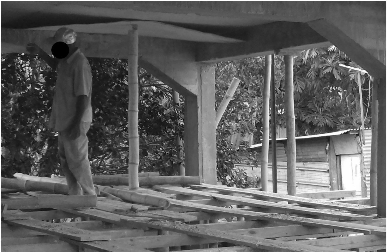
Bako à côté du dernier étau soutenant la dernière planche de coffrage. Il va descendre de l'étage intermédiaire pour laisser la place à Fundi.
