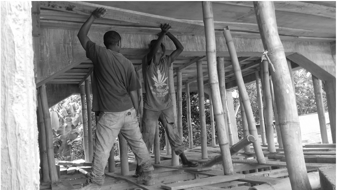
Fundi et Tavandaï retirent un chevron sous l'une des planches de coffrage. Le chevron dans le quart supérieur droit de l'image repose en équilibre sur un unique étau central, permettant de maintenir les planches de coffrage.
