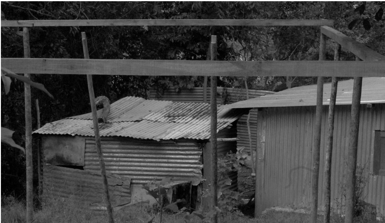
Étape intermédiaire de la construction : pose des poutres horizontales sur les étais en bois.
