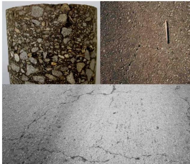
Figure I-9 : Différents aspects des fissures descendantes (d'après Freitas et al.,2003)
