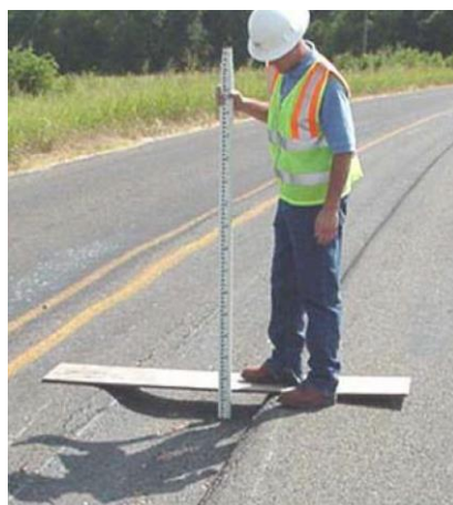
Figure I-10 : Illustration de l'orniérage d'une chaussée (Ali, B. 2006)
