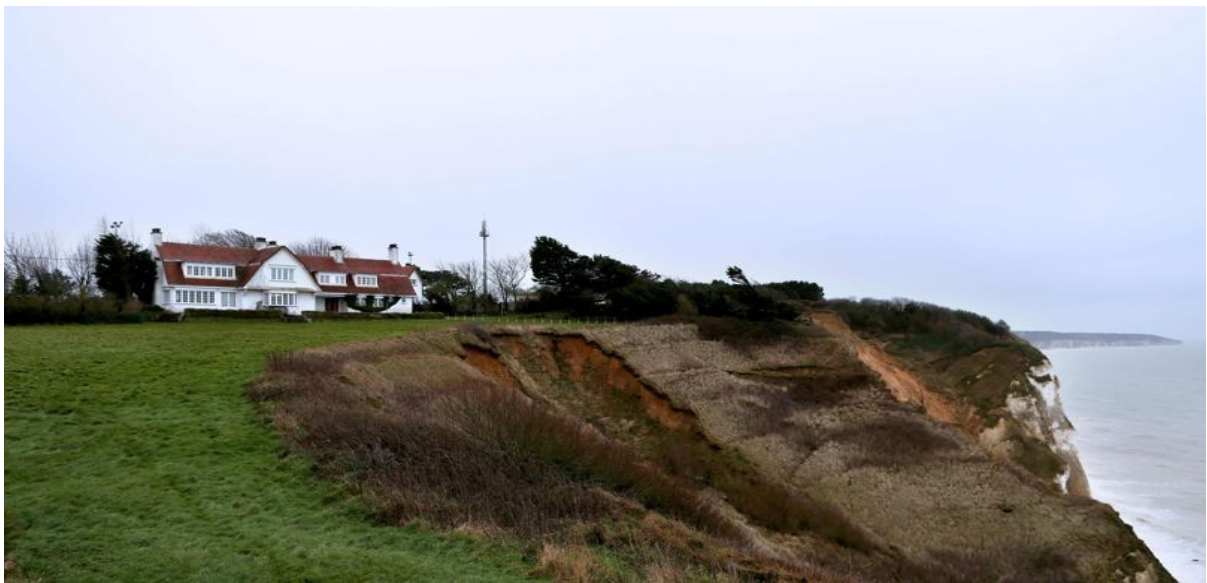
Photo 4 : Érosion menaçant une habitation à Dieppe (février 2016) 24
