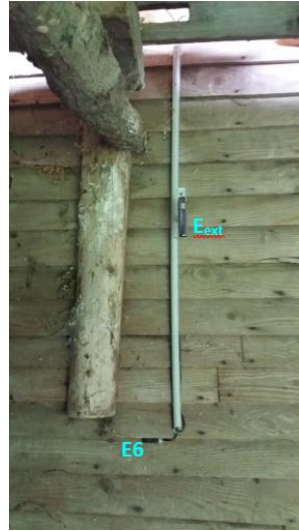
Figure IV-10 : Implantation des capteurs en surface et en ambiance extérieures en paroi nord
