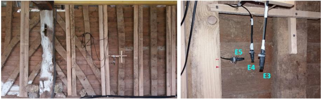
Figure IV-8 : Implantation des capteurs au sein du béton de chanvre en paroi nord
