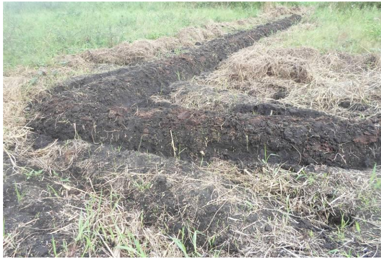
Photo 13 : Construction des casiers avec diguette à Gboa Prise de vue : Hounkanrin B., décembre 2014
