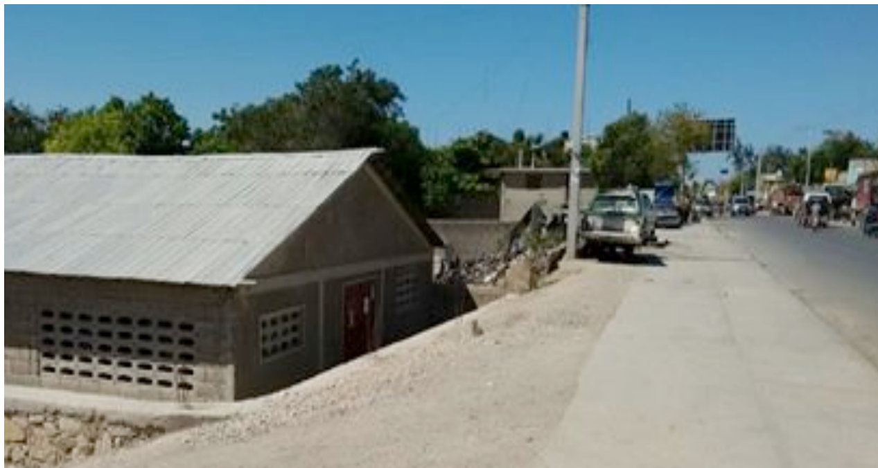
Photo 23. Maison placée à un niveau plus bas que la route à Gattereau, alors que la route draine de l'eau soit du ruissellement urbain soit montée des rivières
