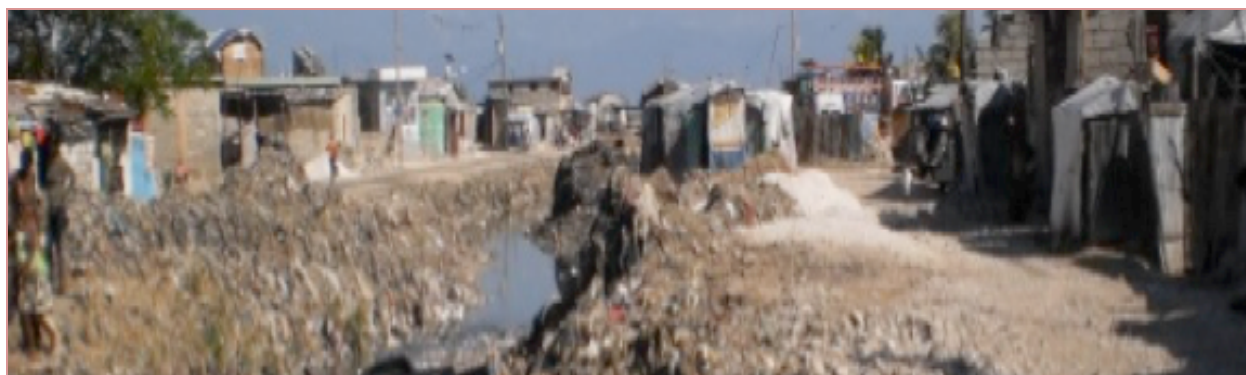
Photo 4. Obstruction d'un canal sur le boulevard Harry Truman (Bicentenaire)
