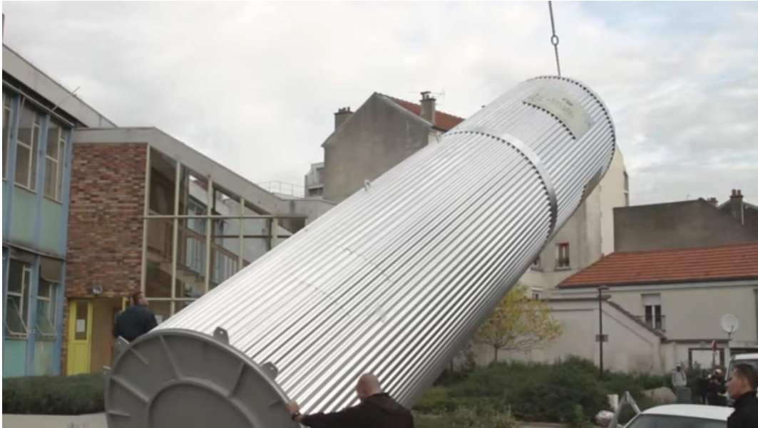
Figure 20 - Système de stockage intersaisonnier - Source : site Internet du BET INEX
