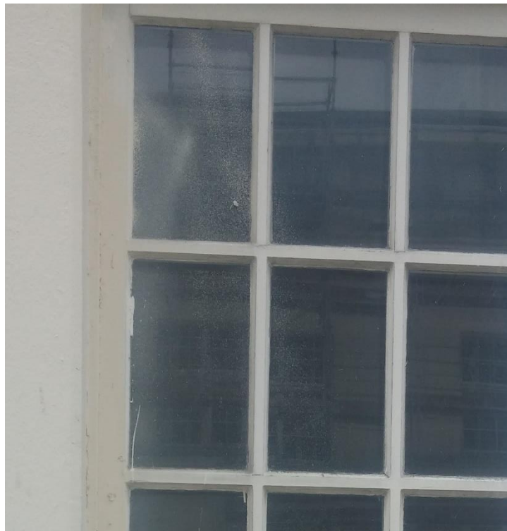
Figure 51 - Détail d'une fenêtre touchée par la projection au pistolet - Source : autrice
