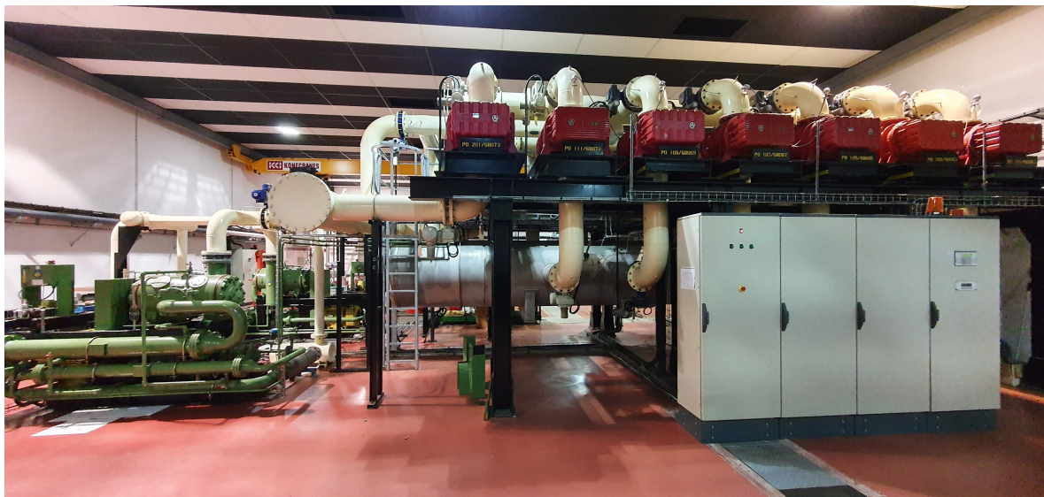
FIGURE 2.4 – Groupe de pompage de l'installation MARHy.
