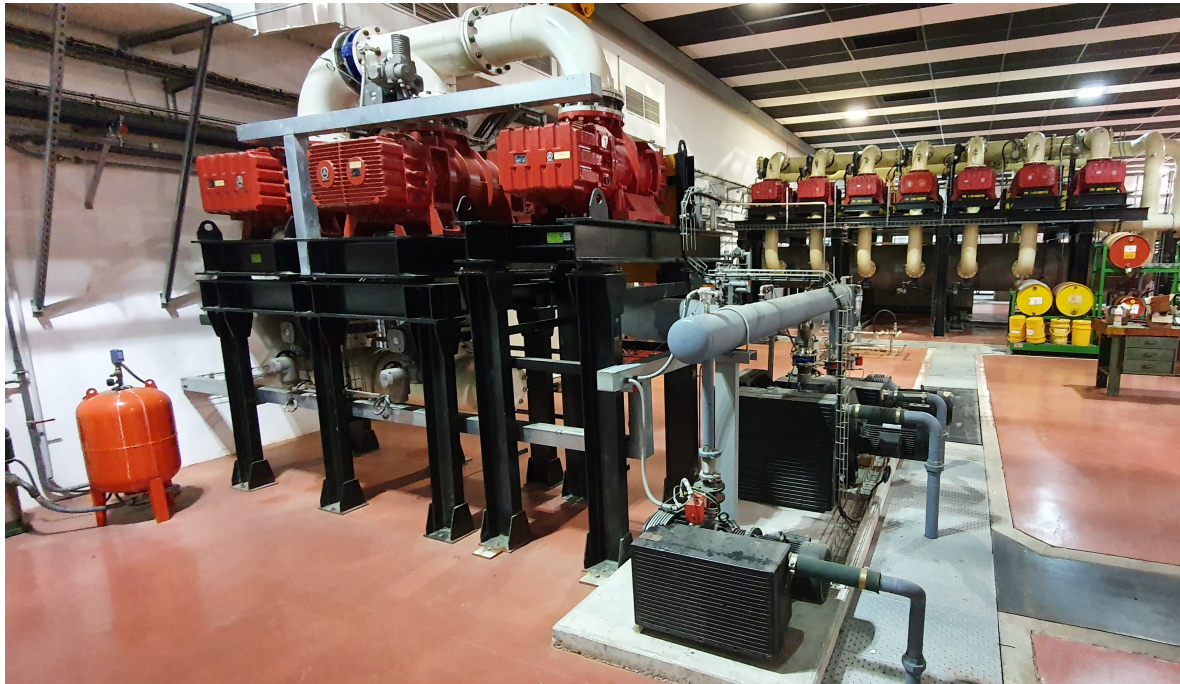
FIGURE 2.8 – Groupe de pompage du moyen d'essais PHEDRA.
