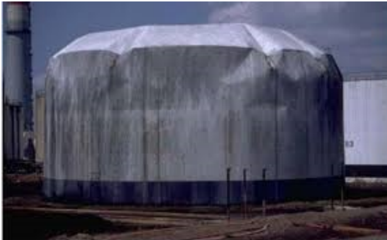
Figure 1.6: Endommagement du toit et de la virole supérieure dû au ballotement du liquide stocké au sein de la raffinerie Tupras, causé par le séisme de Marmara, Izmit Turquie 1999 [4]
