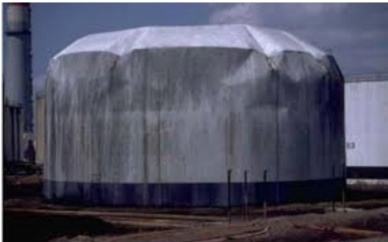
Figure 1.6: Endommagement du toit et de la virole supérieure dû au ballotement du liquide stocké au sein de la raffinerie Tupras, causé par le séisme de Marmara, Izmit Turquie 1999 [4]
