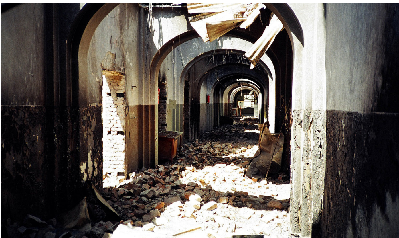
12. Vue du couloir du premier étage du musée national de Kaboul endommagé par les combats, 1994-1996, © Musée national d'Afghanistan
