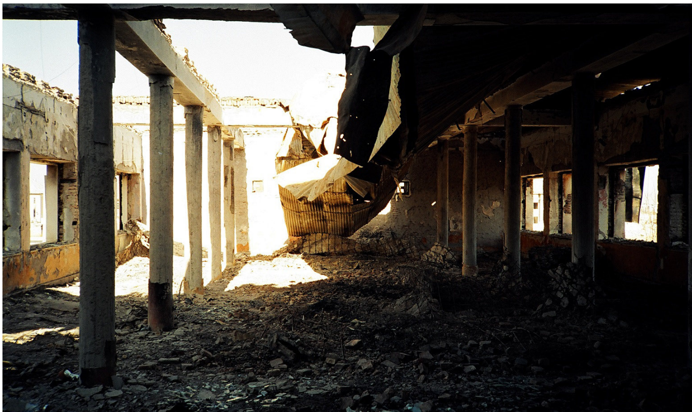
14. Vue d'une salle du premier étage avec le toit percé, février 1994 © Joylon Leslie
