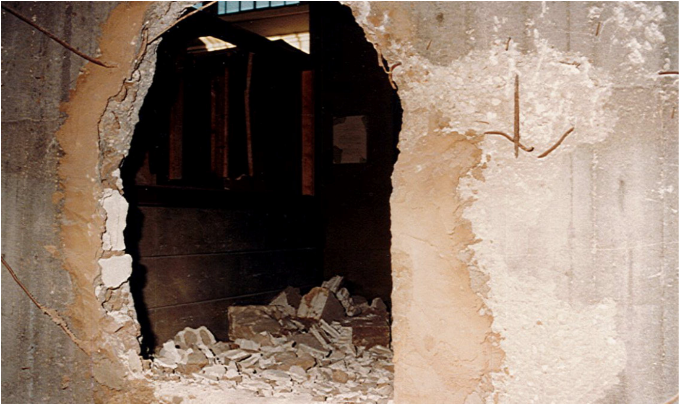
6. Vue du mur de béton percé supposé bloquer l'accès au premier étage du musée national de Beyrouth, 1989, © DGA
