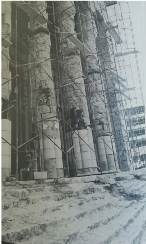
2. Vue des échafaudages le long de la façade du musée national de Beyrouth, 1995, © DGA
