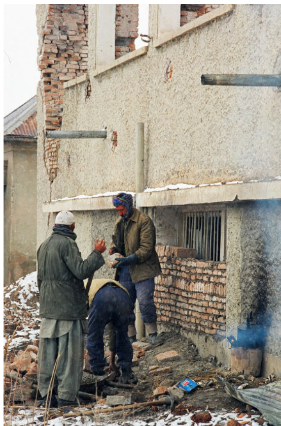
9. Travaux de renforcement des fenêtres du musée national de Kaboul par des murs en briques, 1994-1996, © Musée national d'Afghanistan
