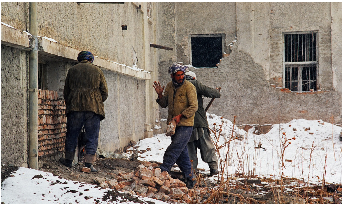
8. Travaux de renforcement des fenêtres du musée national de Kaboul par des murs en briques, 1994-1996, © Musée national d'Afghanistan
