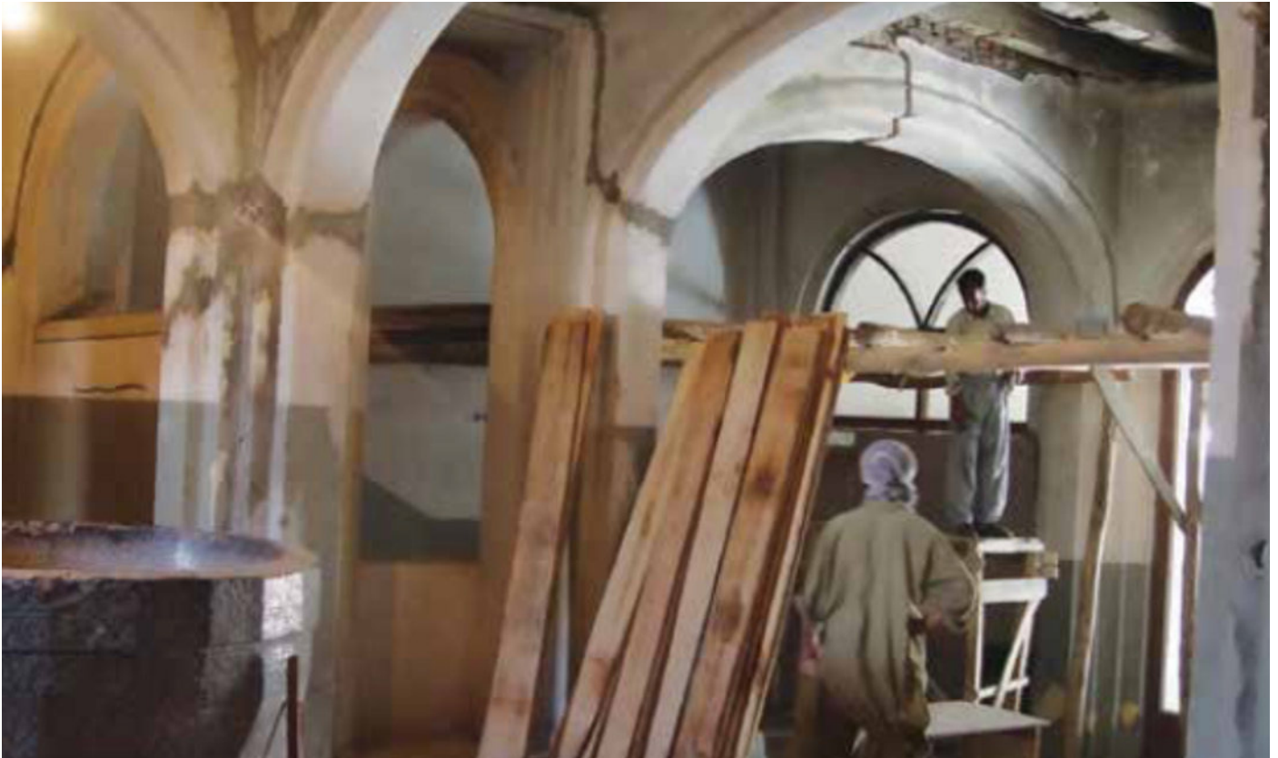
2. Travaux de réhabilitation de l'entrée du musée national de Kaboul, 2003, © Musée national d'Afghanistan
