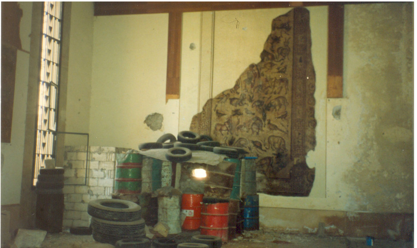
10. Vue du trou réalisé dans la mosaïque du Bon Pasteur rez-de-chaussée du national de Beyrouth , 1991-1993, © DGA
