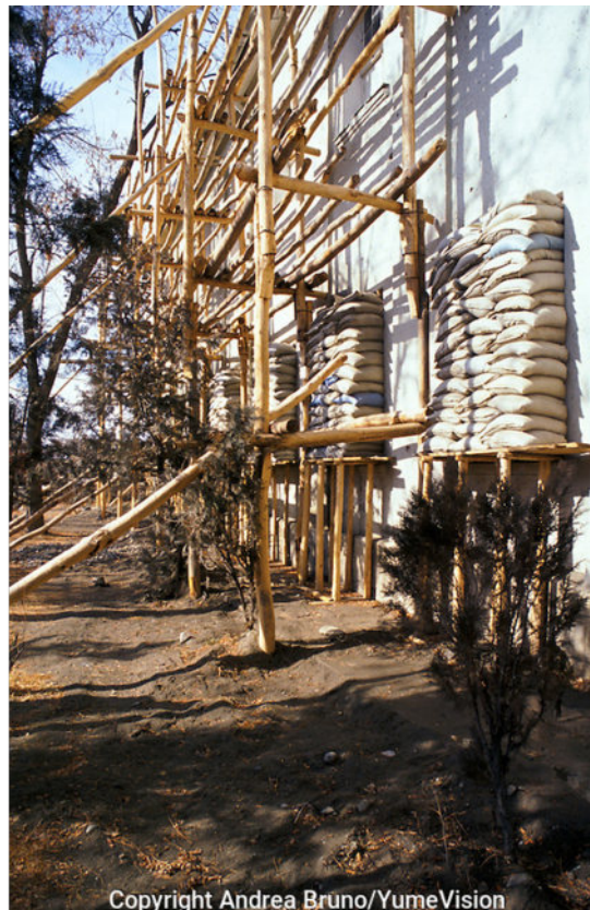
Copyright Andrea Bruno/YumeVision 1. Vue des systèmes de protection installés contre le bâtiment du musée national de Kaboul, 1990, © Andrea Bruno/Yume Vision
