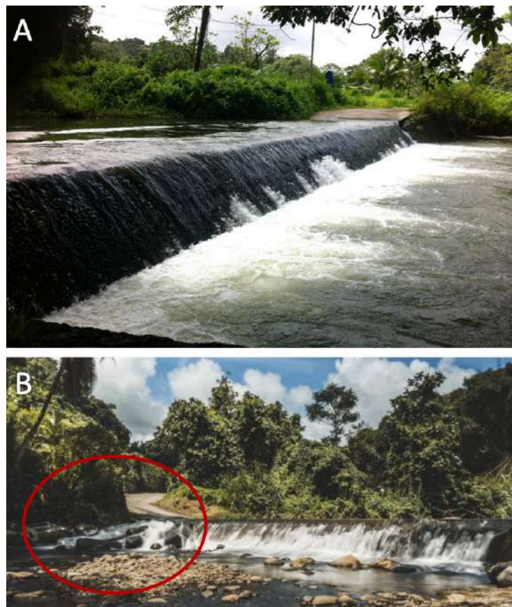
Figure VI.2 : Photographie prise en Martinique, sur la rivière Blanche, présentant (A) un passage à gué, ouvrage en béton, d'origine anthropique, permettant le passage des véhicules d'une rive à l'autre du cours d'eau, ainsi que (B) un ouvrage identique, aménagé avec une passe à poissons, permettant de rétablir la continuité écologique entre l'aval et l'amont des cours d'eau.
