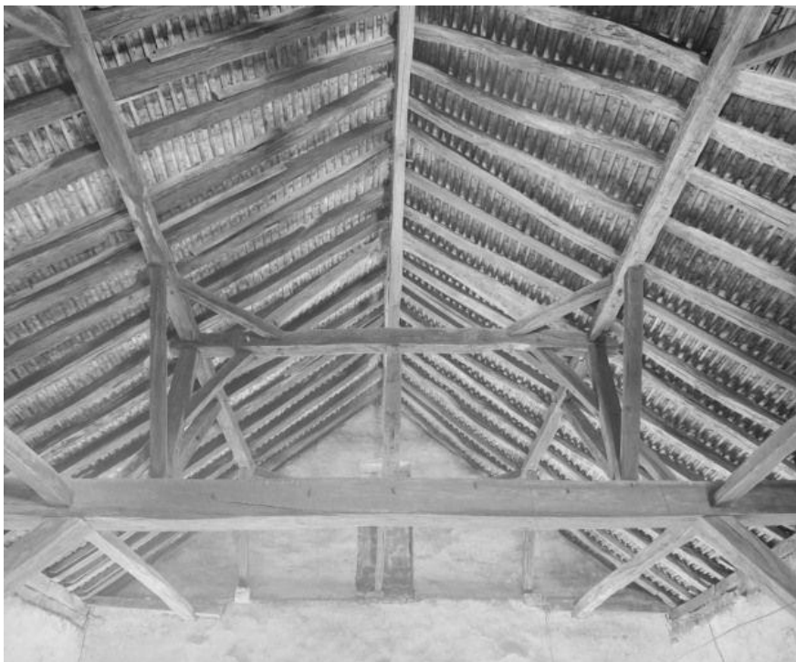
fig. 150 : Charpente de la maison du Grenier à sel de Beaune [21054-14] vue vers le sud (SRI Bourgogne)
