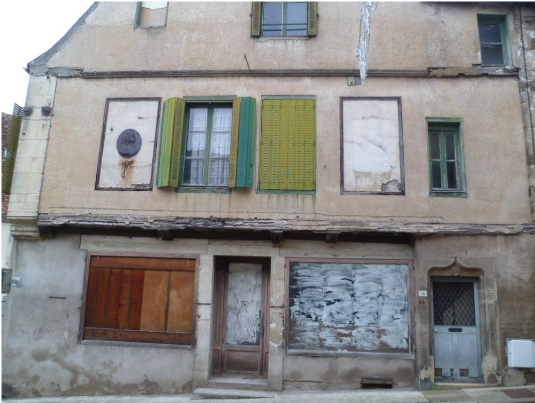
fig. 342 : Semur-en-Auxois [21603-64] : état avant travaux de la façade pignon sud (M1), avec les encadrements publicitaires, cliché A. Lacaille
