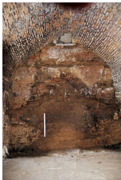
fig. 434 : Paroi rocheuse dans la partie sud du mur ouest de la cave de la maison [21271-111] de Flavigny-sur-Ozerain, taillée afin de fournir des matériaux de construction et de constituer le volume de la cave
