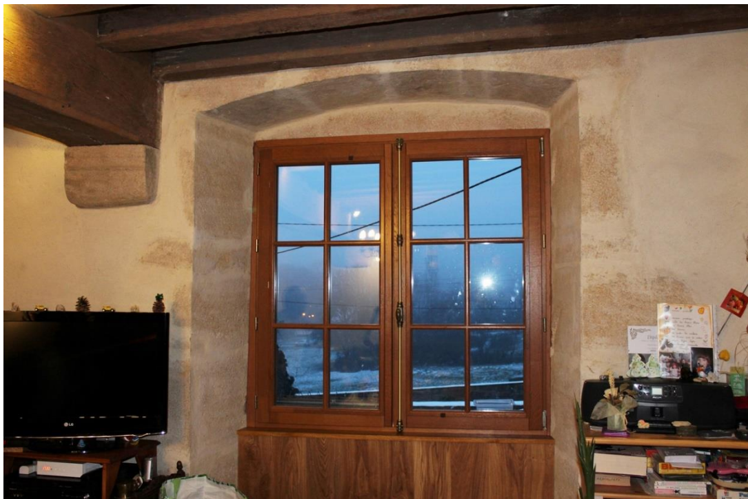
fig. 325 : Pouilly-en-Auxois [21501-6] : fenêtre à croisée du mur M1 au niveau de l'étage, du côté sud, cliché A. Lacaille
