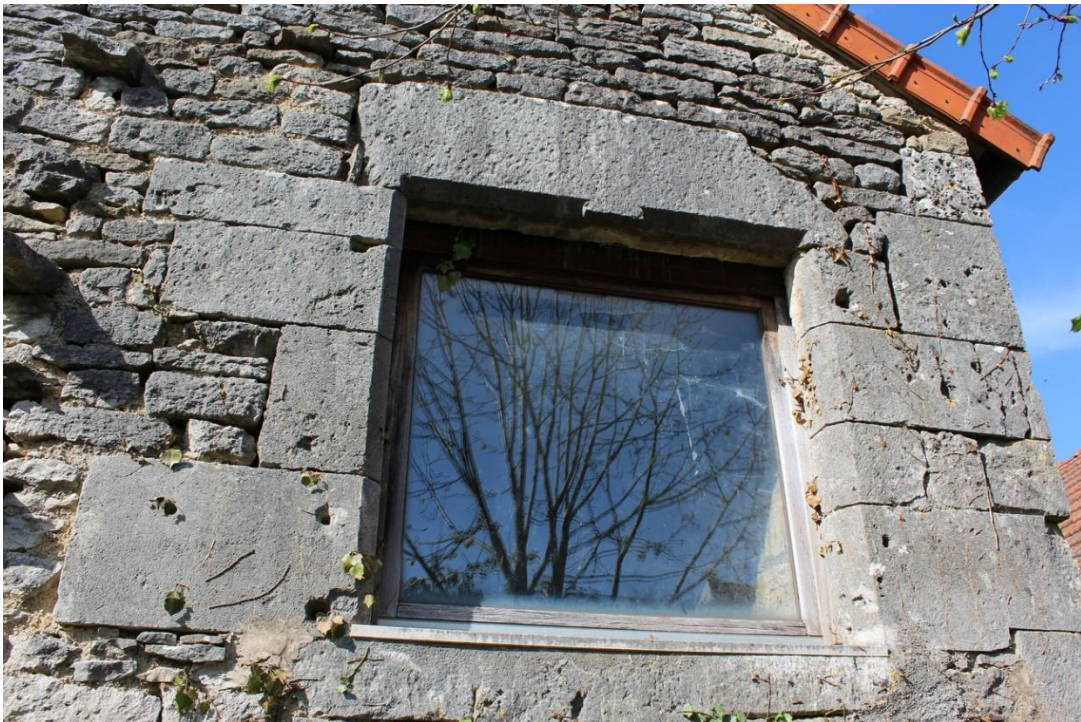
fig. 297 : Flavigny-sur-Ozerain [21271-8] : fenêtre à meneau à l'est de la façade sud M3, cliché A. Lacaille
