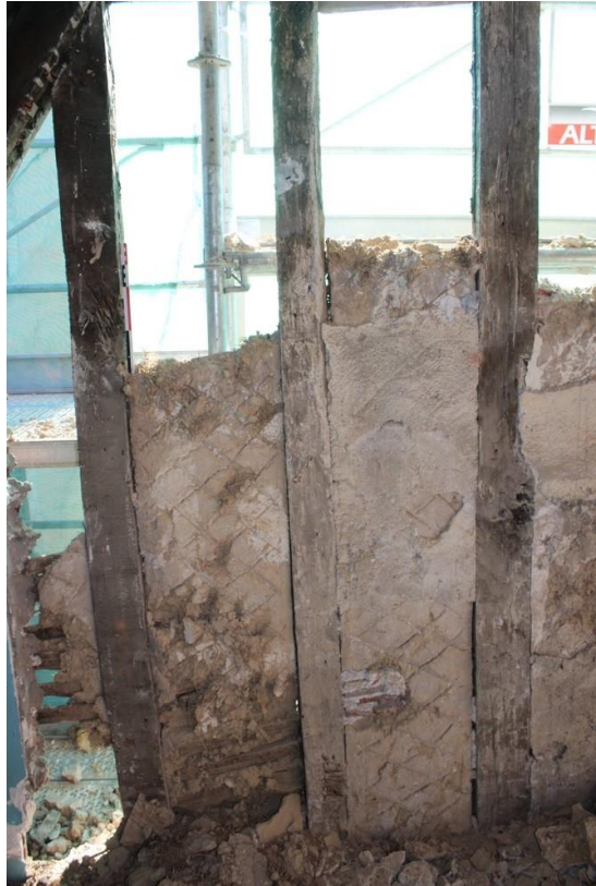
fig. 373 : Semur-en-Auxois [21603-64] : vestiges du torchis intérieur dans la partie orientale du pan de bois, au niveau du comble, cliché A. Lacaille
