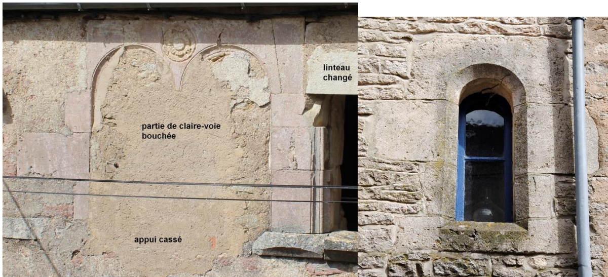
fig. 236 : Fenêtres à linteau découpé d'un ou plusieurs arcs à Flavigny-sur-Ozerain [21271-85] et aux vestiges de la claire-voie de Moutiers-Saint-Jean [21446-5]
