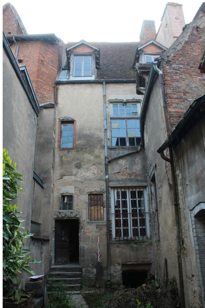
fig. 419 : Auxonne [21038-22] : la façade arrière M3, sur cour. La tourelle d'escalier est visible à gauche, cliché A. Lacaille
