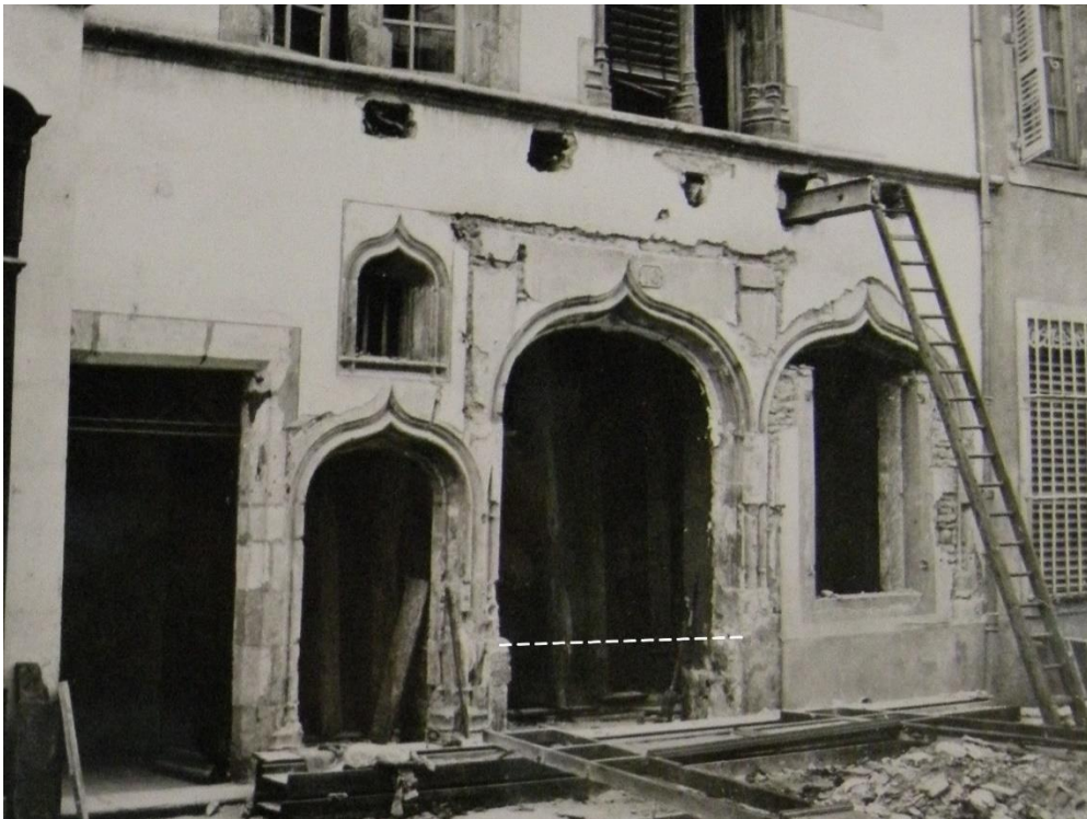
fig. 506 : Cliché de la façade de Beaune [21054-24] au moment de la réfection du rez-de-chaussée en 1910 (AM Beaune 42W119).
