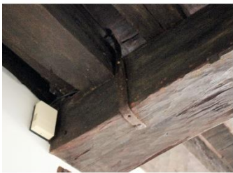
partie d'attache de maintien d'une grosse solive qui sert de support à la façade en pan de bois au rez-de-chaussée à Semur [21603-36]
