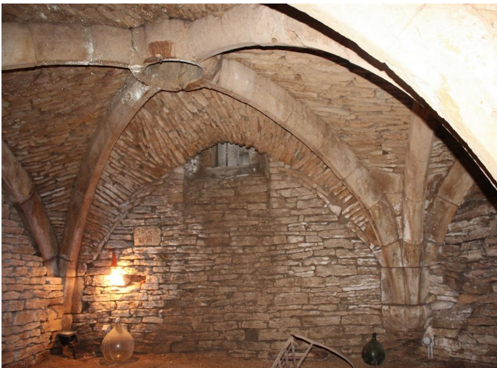
fig. 134 : Vue vers l'est de la voûte de cave de Rougemont [21530-12] avec le trou à la rencontre des ogives
