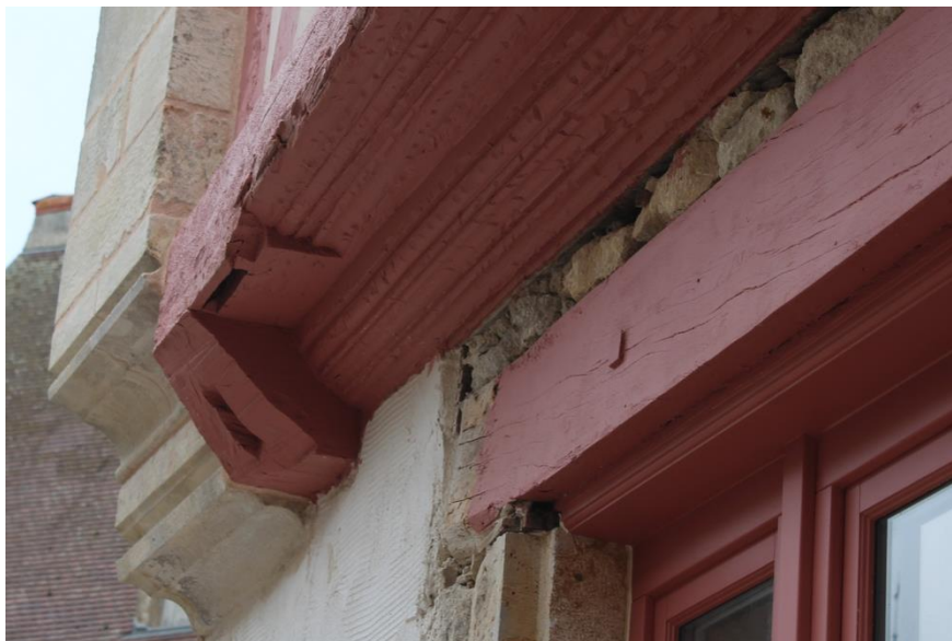
fig. 367 : Semur-en-Auxois [21603-64] : sablière basse à la base du pan de bois du côté de l'encorbellement ouest. L'about du sommier a été scié, cliché A. Lacaille
