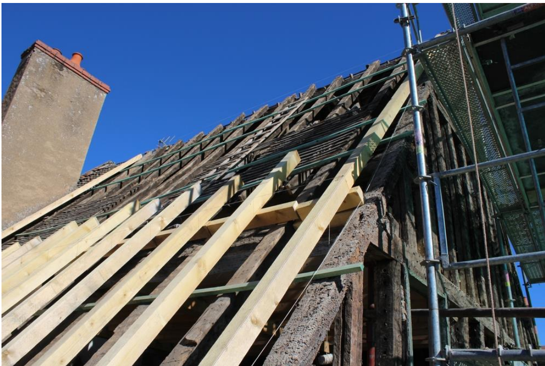
fig. 343 : Semur-en-Auxois [21603-64] : pose de nouveaux chevrons au cours des travaux, cliché A. Lacaille
