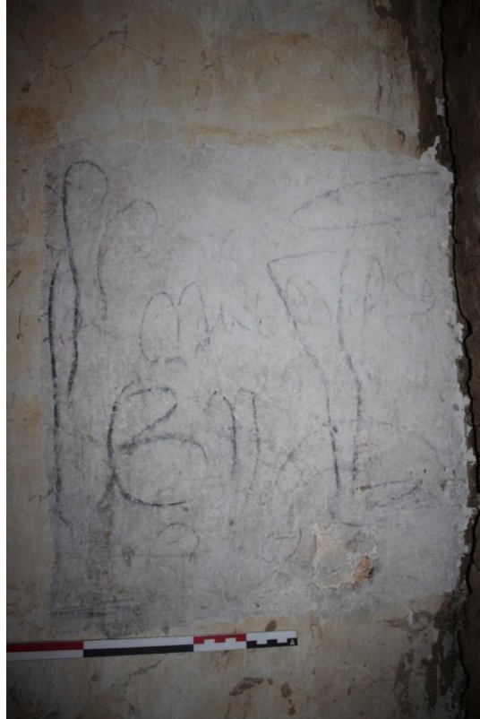
fig. 428 : Auxonne [21038-22] : sondage dans l'enduit du mur M2 à l'étage de B qui atteste de la conservation de graffiti ancien, cliché A. Lacaille
