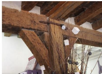
attache de maintien des poutres maîtresses appuyées contre le poteau central au rez-de-chaussée d'Auxonne [21038-9]
