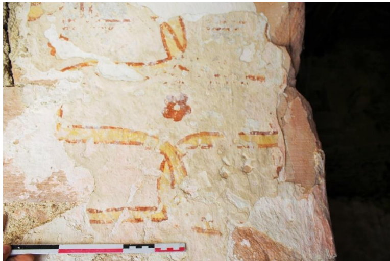
fig. 112 : Cliché et relevé de l'encadrement nord d'une baie à l'étage de la maison [21446-5] de Moutiers-Saint-Jean avec vestiges d'enduits peints
