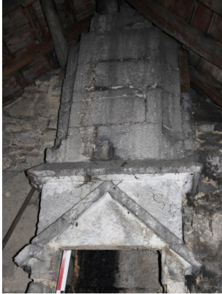
fig. 262 : Conduit de cheminée de Vitteaux [21710-16]
