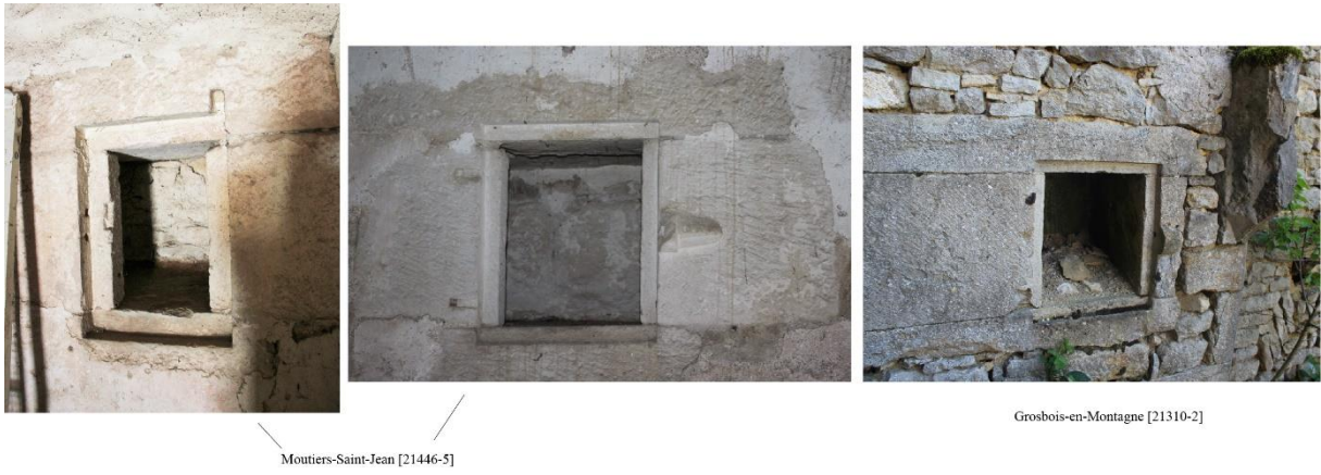
fig. 272 : Niches à l'étage de Moutiers-Saint-Jean [21446-5] (dans la même pièce) et à Grosbois-en-Montagne [21310-2]
