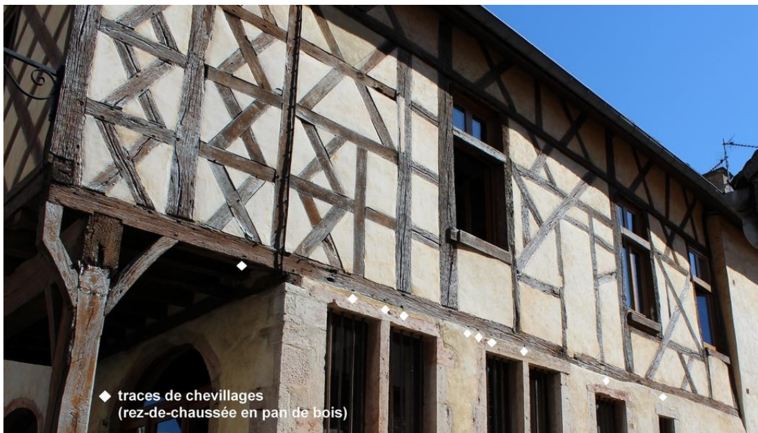
fig. 99 : Pan de la façade gouttereau ouest de la maison [21038-4] d'Auxonne. Certaines poutres ont été remplacées et des traces de chevilles attestent de la présence initiale de pan de bois en rez-de-chaussée
