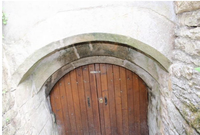
fig. 332 : Pouilly-en-Auxois [21501-6] : couverture de la porte de la cave, en M1, cliché A. Lacaille
