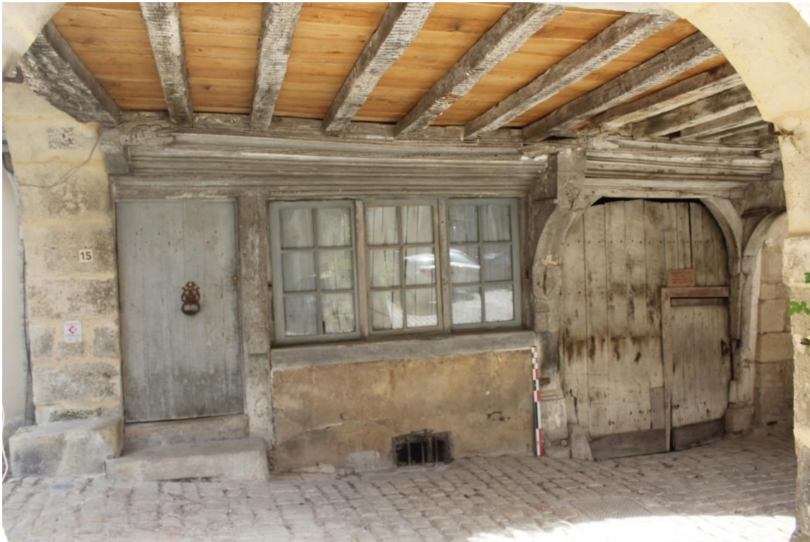
fig. 54 : Aspect du porche d'accès à la cour arrière de Noyers [89279-17] en façade sur rue, sous l'avant-solier
