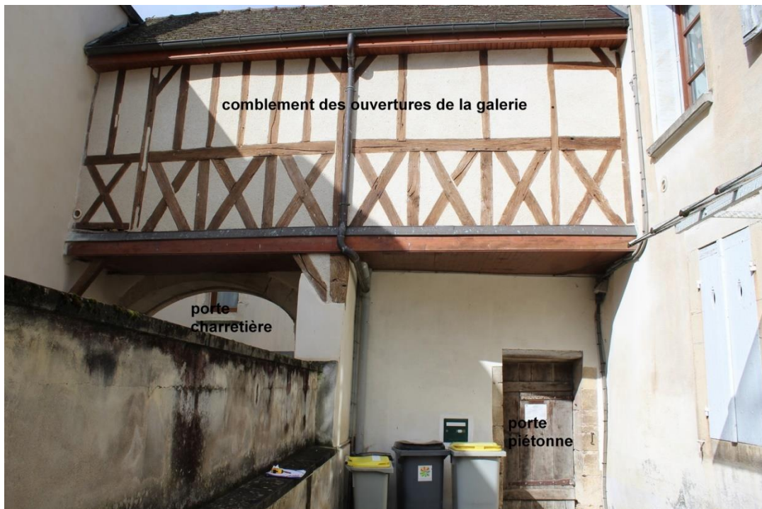
fig. 191 : Ancienne galerie démolie en 1843 dans l'hôtel Rolin à Dijon [21231-49], dessin tiré des mémoires de la CACO, BM Dijon Est CA0002/01 et galerie commune à Fontaine-lès-Dijon [21278-13] et [21278-14]
