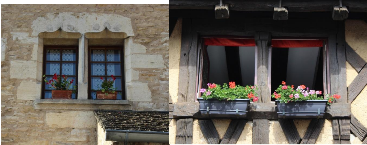
fig. 238 : fenêtres à meneaux en pierre à Fontaine-lès-Dijon [21278-10] et en bois à Châteauneuf [21152-15]
