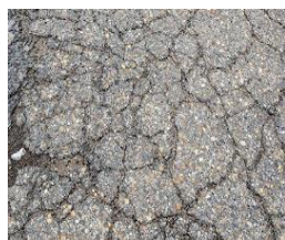
Fissuration par Fatigue
