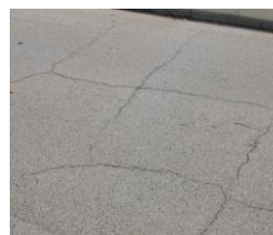
Fissuration des Blocs
